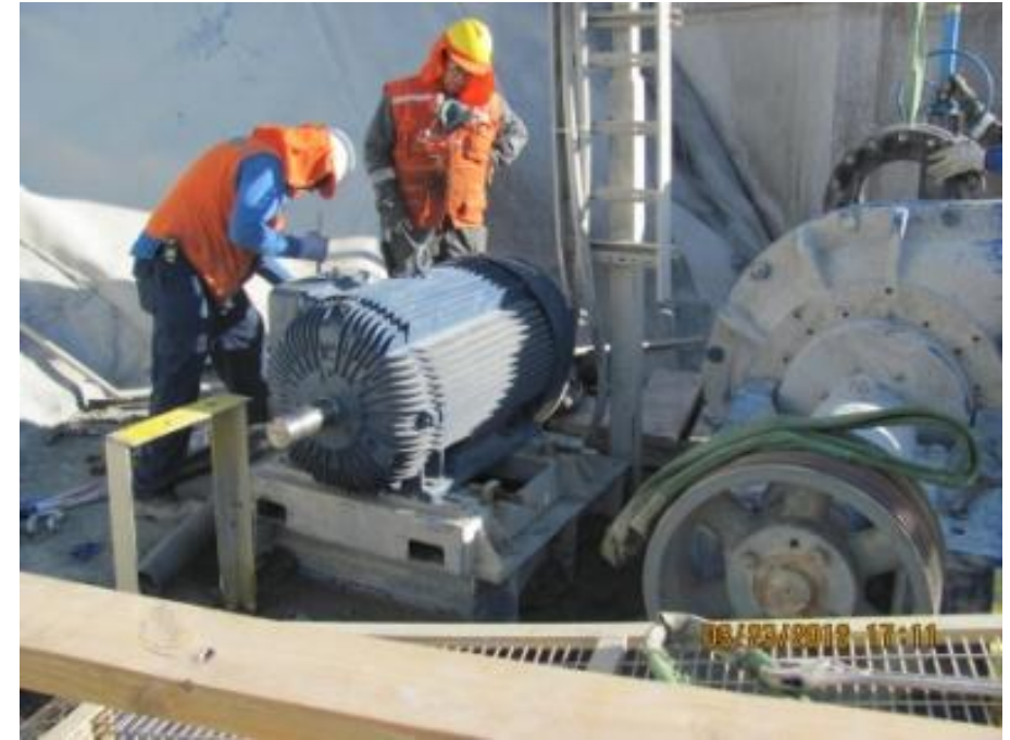
MOTORES BAJA TENSIÓN CELULOSA ARAUCO
