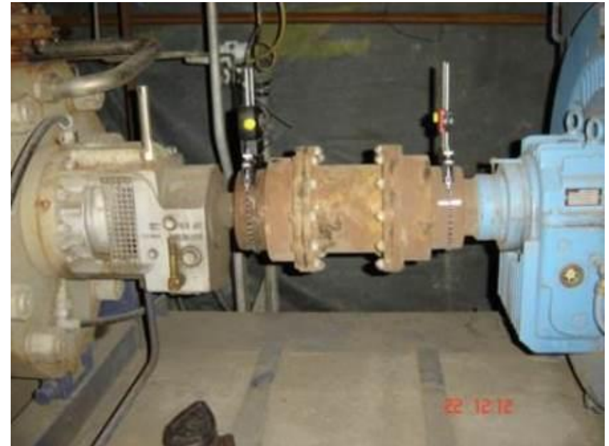
MOTORES BAJA TENSIÓN CELULOSA ARAUCO
