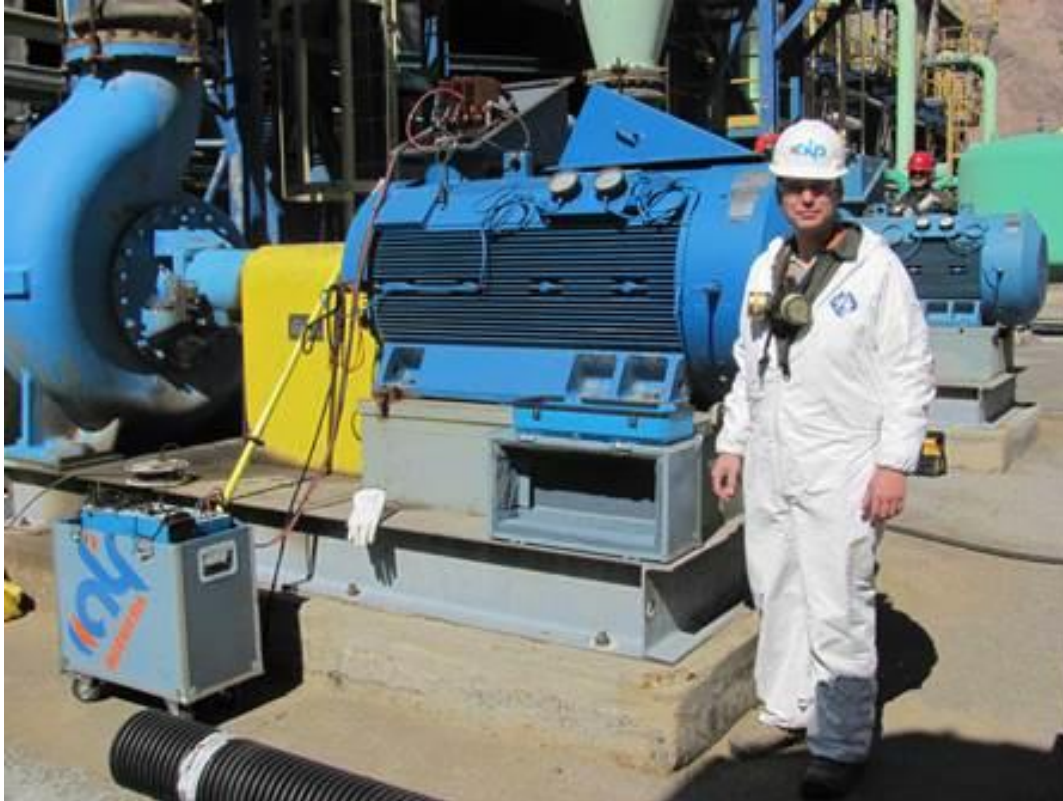
MOTORES MEDIA TENSIÓN DIVISIÓN EL TENIENTE
