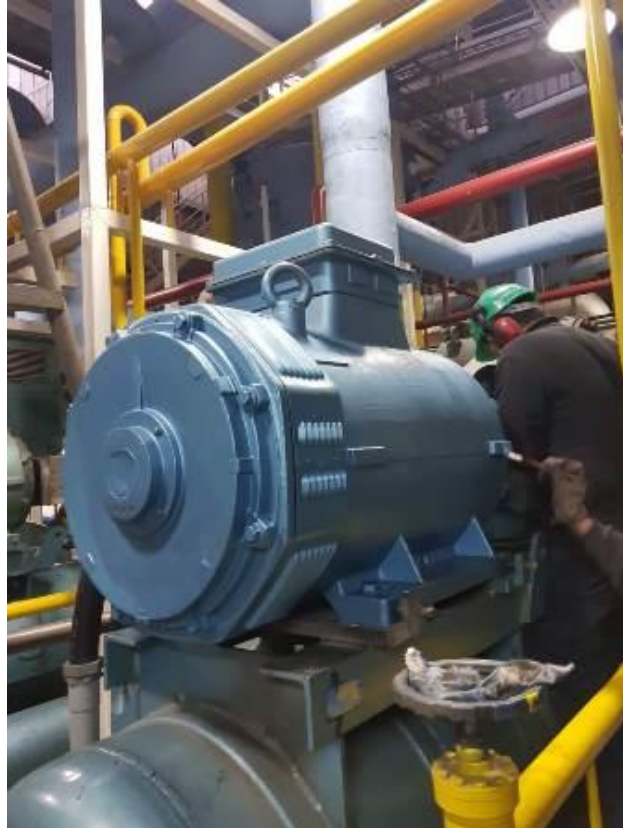
COMPRESOR CELULOSA ARAUCO
